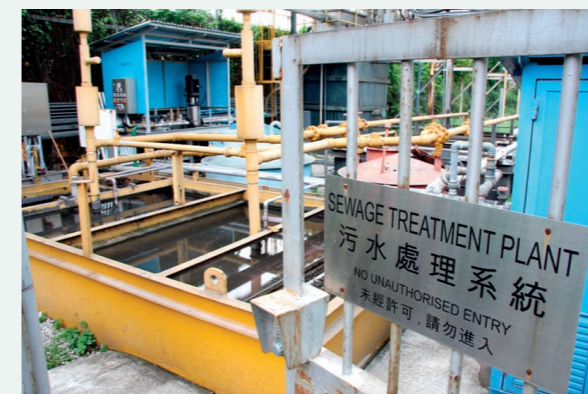
友盟建築材料的污水處理系統。
