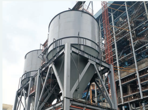
四川华电广安公司全厂灰渣综合利用项目
