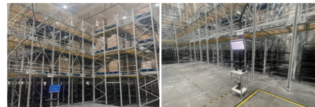
▲ 四向穿梭车 + AGV 机器人存储
