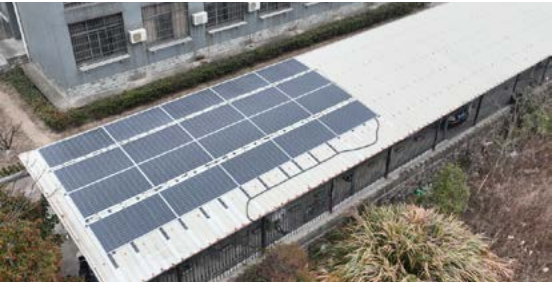
舟山管理中心“光儲充一體化”充電站光伏板
