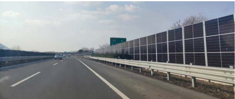
申嘉湖高速聲屏障光伏項目
