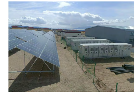
西藏扎布耶光伏储能设施
